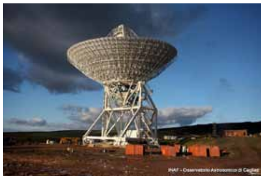
Fig. 2 Il radiotelescopio SRT in costruzione a Pranu Sanguni, località nel comune di San Basilio, a 35 km da Cagliari.
